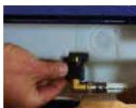
Montage d'un raccord MeplaFix sur l'arrivée d'eau de bâti-support pour WC en 1/2".
